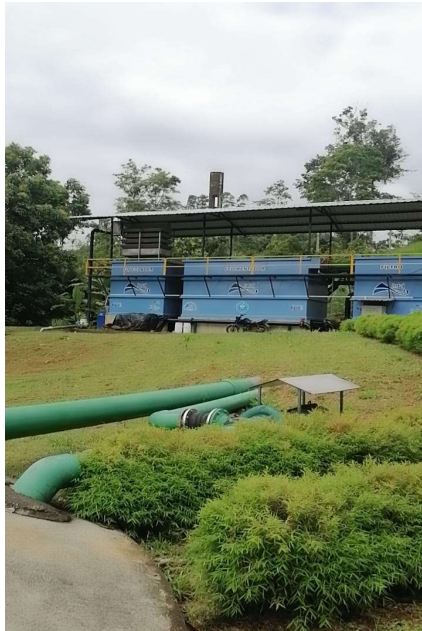
Planta compacta de tratamiento de agua
