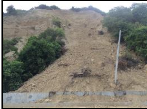
Figura 32. Deslizamiento de tierra en San Vicente – Manabí Elaborado: Equipo Técnico PRAS, 2016
