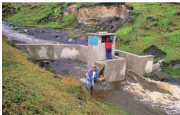
Estación limnimétrica « Humboldt » construida en 1999 por el IRD y la Empresa Municipal del Agua de Quito (EMAAP-Q) para el monitoreo hidrológica de la cuenca del glaciar 12 Los Crespos del Antisana. Foto B.Francou
